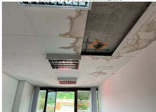
Foto 6 | Perdita evidenziata in data odierna
